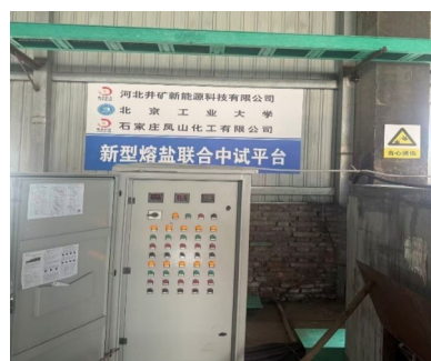
图3 DCS 控制系统
