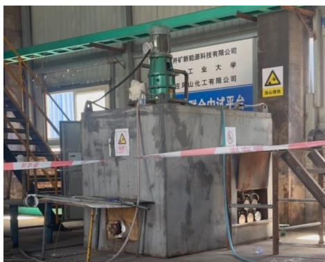
图2 河北井矿新能源公司熔盐储罐装置
