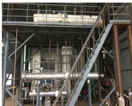
图1 浙江大学电加热熔盐储罐装置
